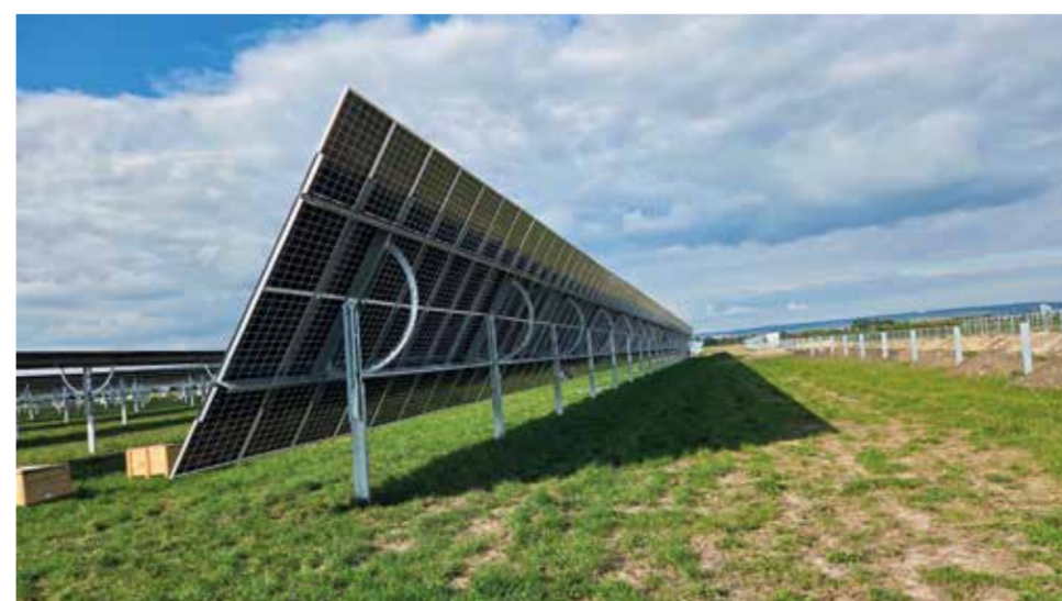
Agrivoltaika na trackerových konstrukcích
