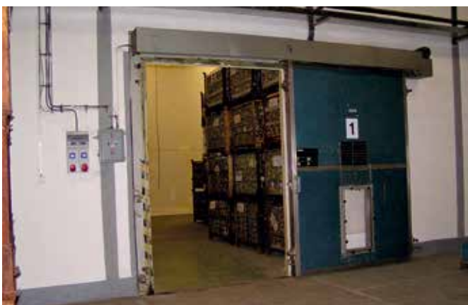
Pohled do chladírenské komory
