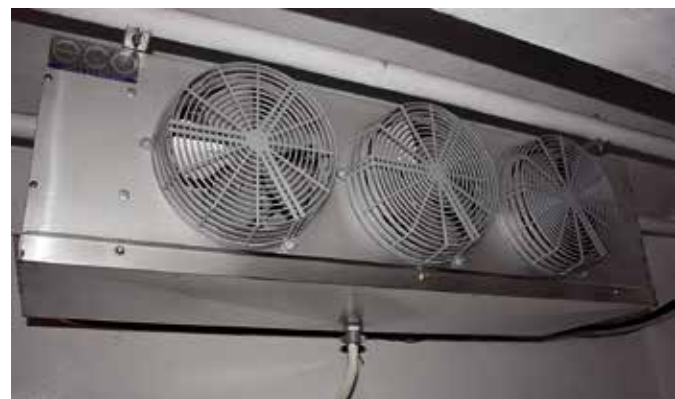
Výparníky jsou zpravidla zavěšeny nad chladírenskými vraty
